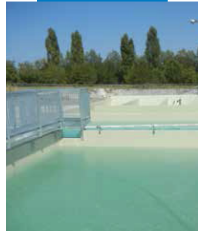
Su yalıtımı Purtop 1000 ile sağlanmış depolama tankları
