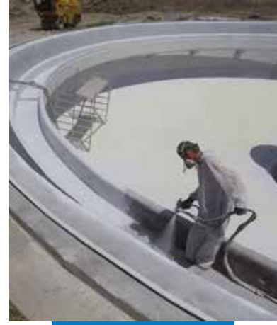
Purtop 1000'in endüstriyel depolama tanklarına uygulanması
